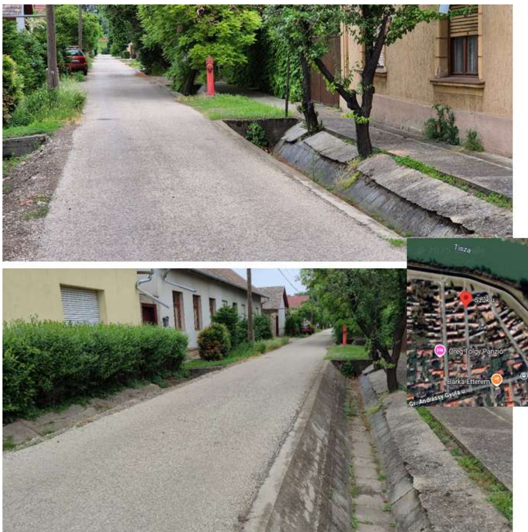
35. ábra: Szűk utca, mederlapos csapadékvíz csatorna
